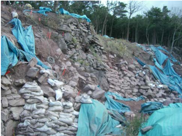
写真-2 屋嶋城城門石垣の崩落の状況
