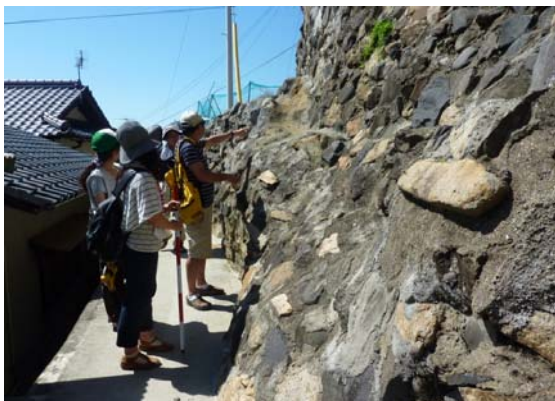
写真一3 石積みの劣化
