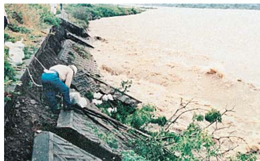
図 2 重信川の氾濫の様子
