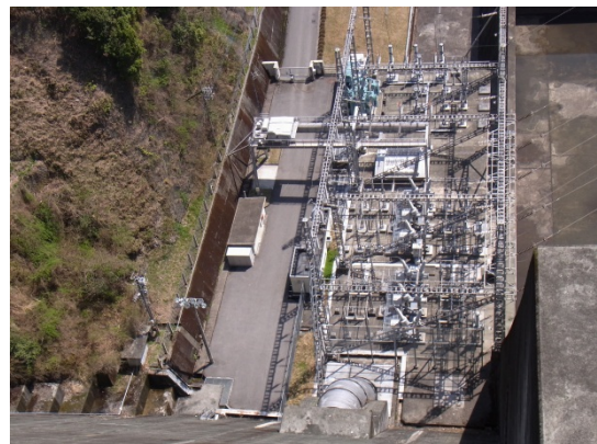
図 2 早明浦発電所
