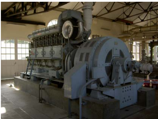
写真一五 ディーゼル発電機
