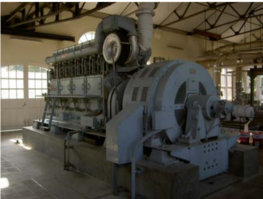
写真一五 ディーゼル発電機
