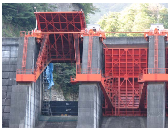
写真14 ゲートが上がった状態
