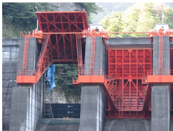
写真14 ゲートが上がった状態
