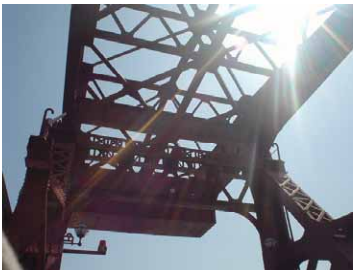
写真 - 3 開閉部分 カウンターウエイト
