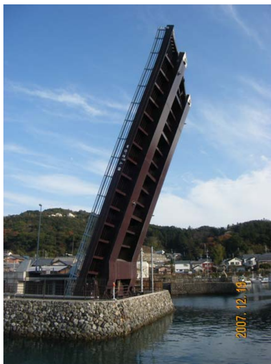
写真－３ 可動橋全開時の様子 2
