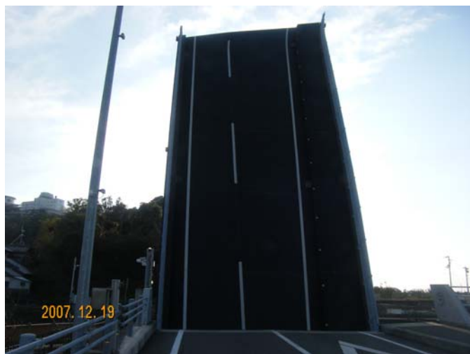
写真－２ 可動橋全開時の様子 1
